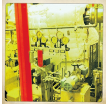
Maskineri i Amagerforbrændingens turbinegenerator. Foto: Christina Majcher
